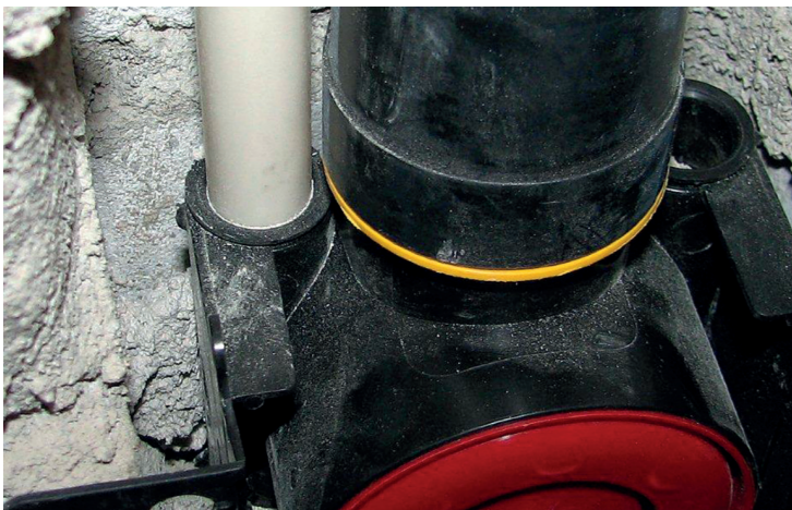
Bild 11. Das Schutzrohr ist besonders wichtig, wenn die Verkabelung durch Mauerwerk oder Beton verläuft.
